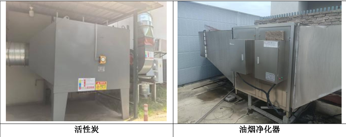
图 3-2 废气处理设施现场图
